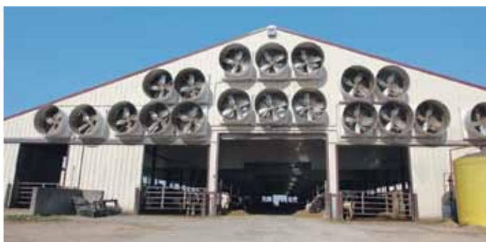
Viele Ventilatoren sorgen für Top-Luftqualität, auch dank günstiger Energie.
